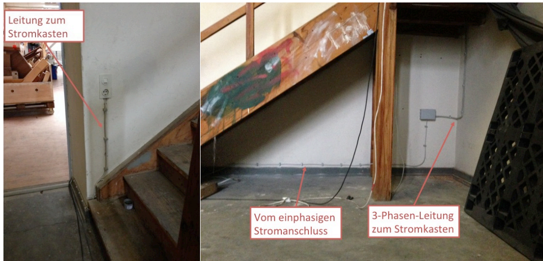
Abbildung 3: Stromanschluss am Treppenaufgang
